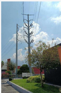
Figura 9. Vista general. Poste de transición de doble circuito de 115 kV en el cruce del río Santa Catarina, Monterrey. La estructura concentra las dos acometidas aéreo-subterráneas asociadas a la red de la Macroplaza.
