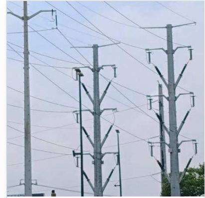
Figura 6. Aplicación del sistema de 115 kV en la modernización de subestación sustituida por subestación blindada de 400 kV.
