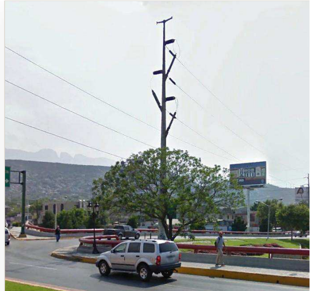
Figura 8. Instalación original, 1983. Vista del primer diseño del poste de transición aéreo-subterránea de 115 kV, de un circuito, instalado al sur del río Santa Catarina como parte de la nueva red subterránea asociada al proyecto de la Macroplaza de Monterrey.
