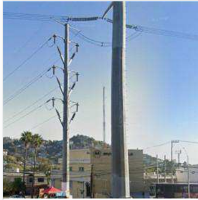
Figura 5. Condición urbana en la que el cruce con una línea de transmisión de 400 kV impide la continuidad aérea de la línea de 115 kV.
